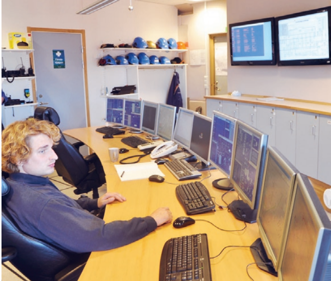
Det är mycket att hålla reda på i Kraftvärmeverkets driftcentral. Mattias Melin är en av dem, som jobbar där.
