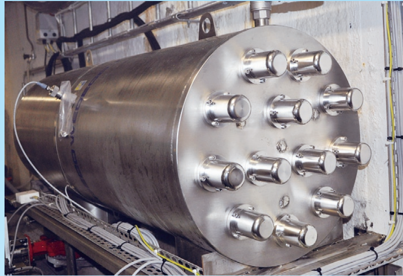
UV-aggregatet som installerades för några år sedan har gjort Härnösands vatten betydligt bättre.
